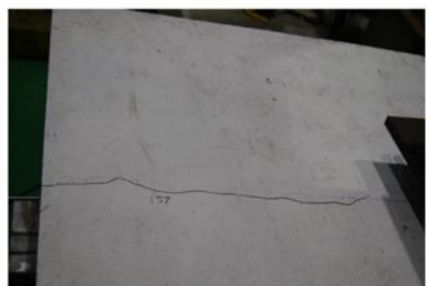
c) Longitudinal crack
